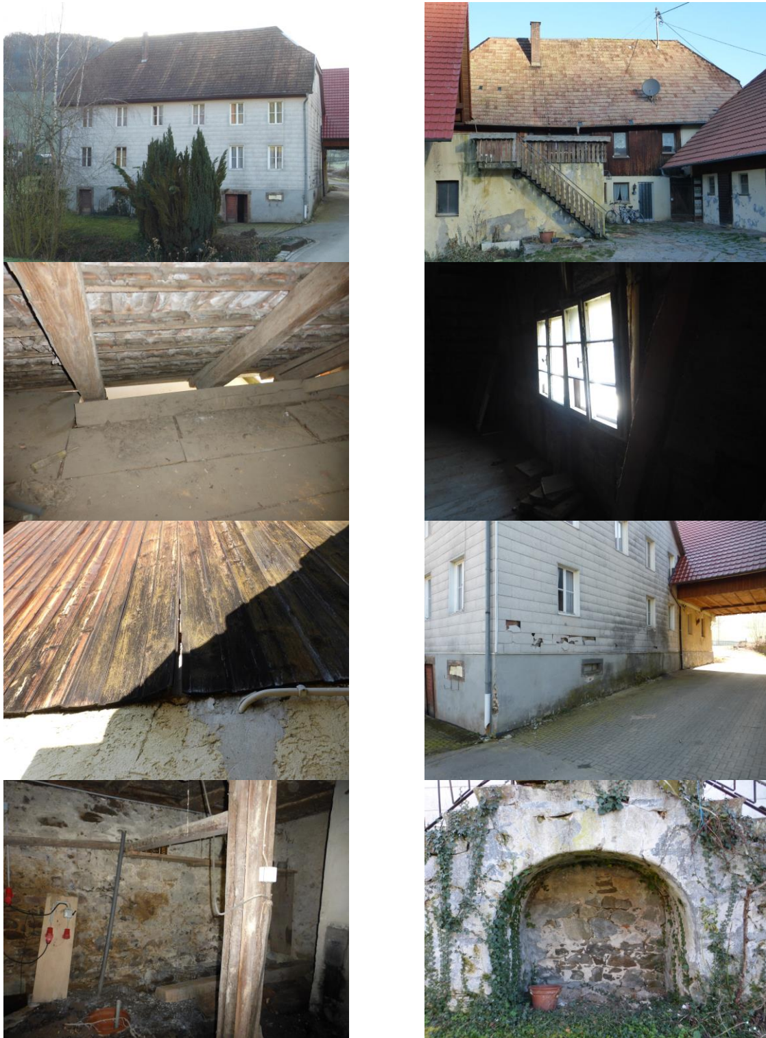
Abb. 4: Gebäude 3, Ansicht NO und SW Seite, Einflugöffnung im Traufbereich zu Gebäude 4 hin, fehlende Fensterscheiben in der Giebelwand, verworfenes Schalungsbrett, zerbrochene Faserzementplatten, Kellerwand, Gewölbe unter Treppenaufgang
