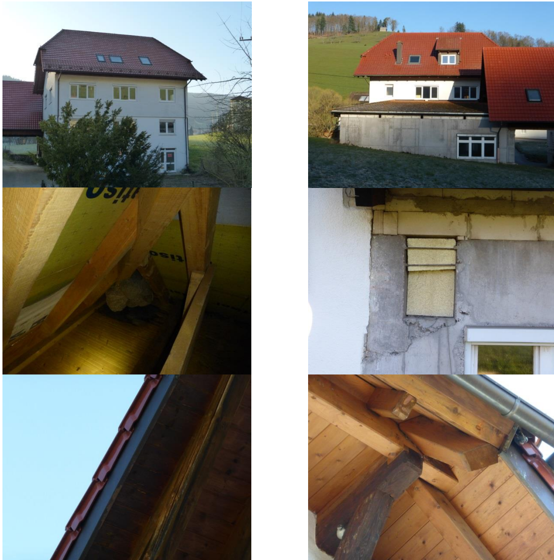
Abb. 2: Gebäude 1, Ansicht von Nordwest und Südost, Hornissennest in oberster Dachebene am südwestlichen Giebel, Ortgangbereich mit Blech, Spalten in der Südost-Fassade des Werkstattanbaus, einer der Walmbereiche, bei dem der Einflug von Haussperlingen beobachtet wurde.
