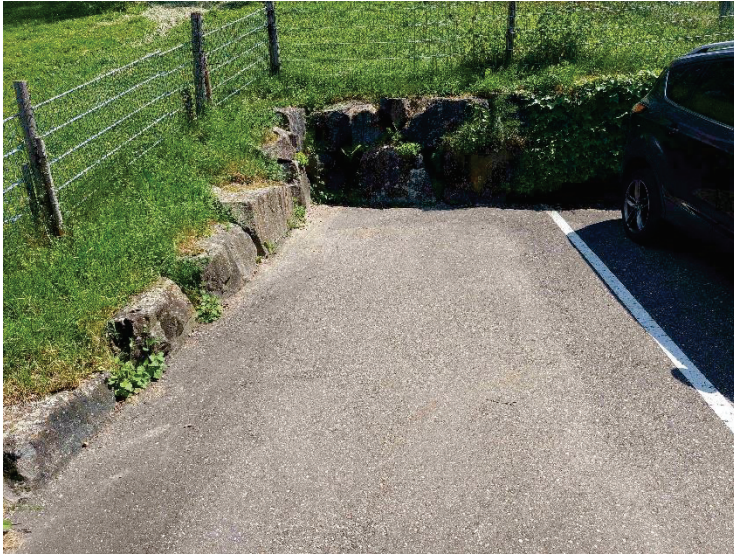
Bild 3: Links im Bild die durch das Vorhaben beanspruchte Naturstein-Mauer, hinten im Bild die 3 m Natursteinmauer, die aktuell von der Mauereidechse besiedelt ist und bestehen bleiben
