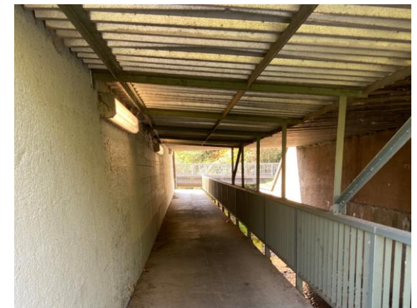
Beleuchtung in der Unterführung
